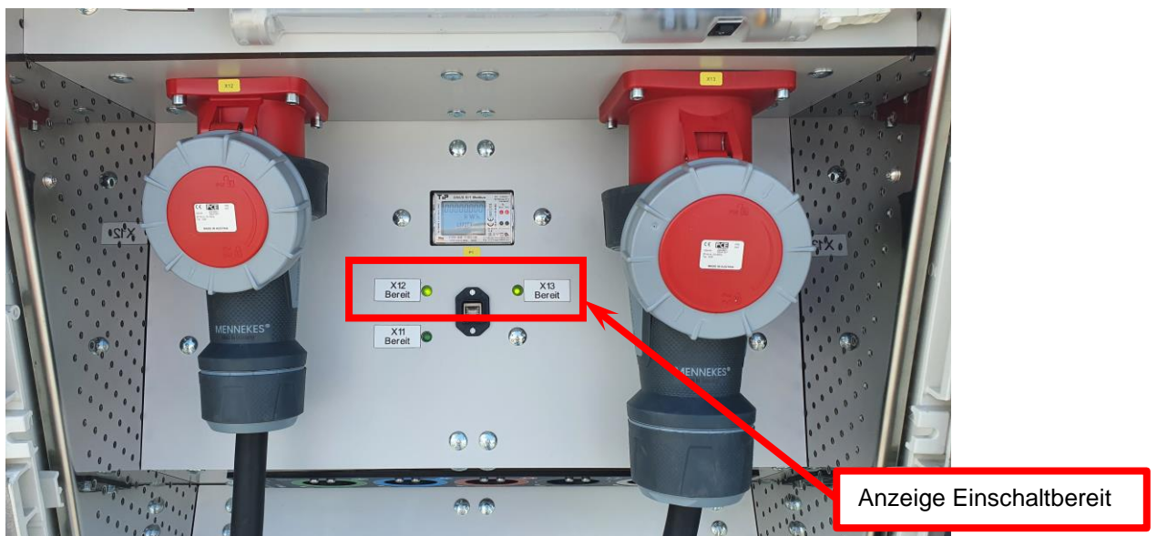
Bild 7: CEE Stecker einschaltbereit
